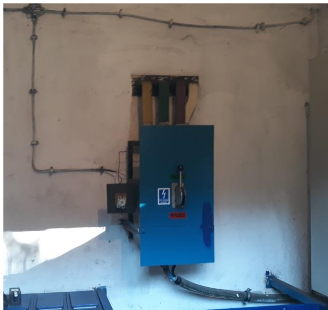
Zdjęcie nr 1 – Rozłącznik w głównym torze zasilania z transformatora
